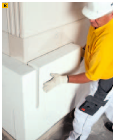
8 Décalage des plaques au niveau des angles de bâtiment
